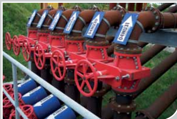
安装在DONG能源公司的枫诺管夹阀
