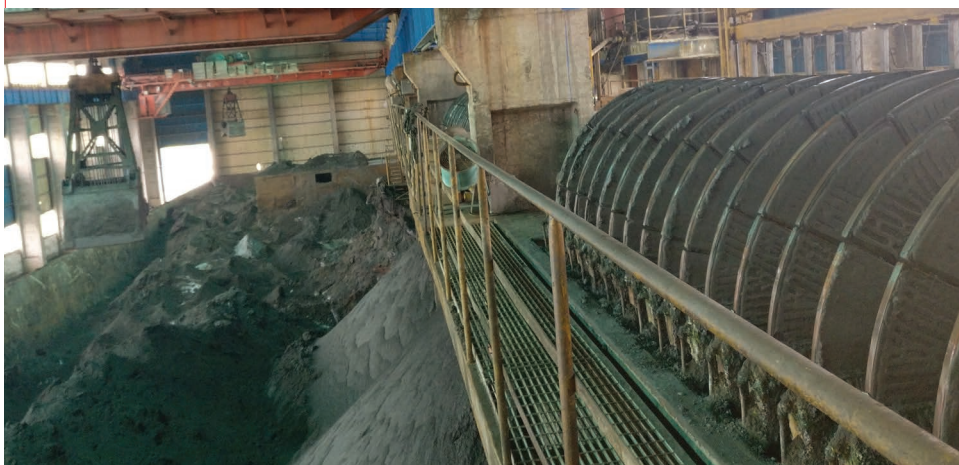
Keraaminen Flowrox-Kiekkosuodatin toimii erittäin hyvin kuparilietteen suodatuksessa.
